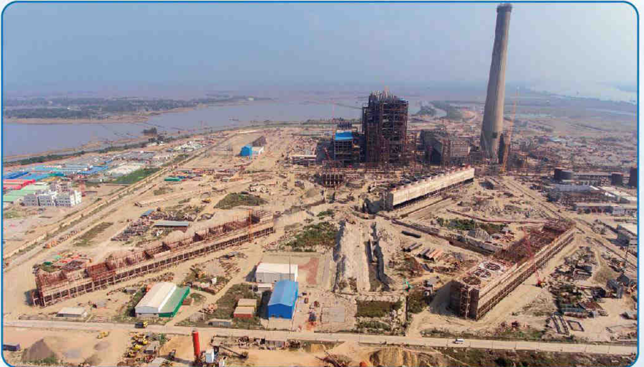
মৈত্রী ২x৬৬০ মেগাওয়াট সুপার থার্মাল পাওয়ার প্রজেক্ট কুলিং টাওয়ার কমপ্লেক্স
