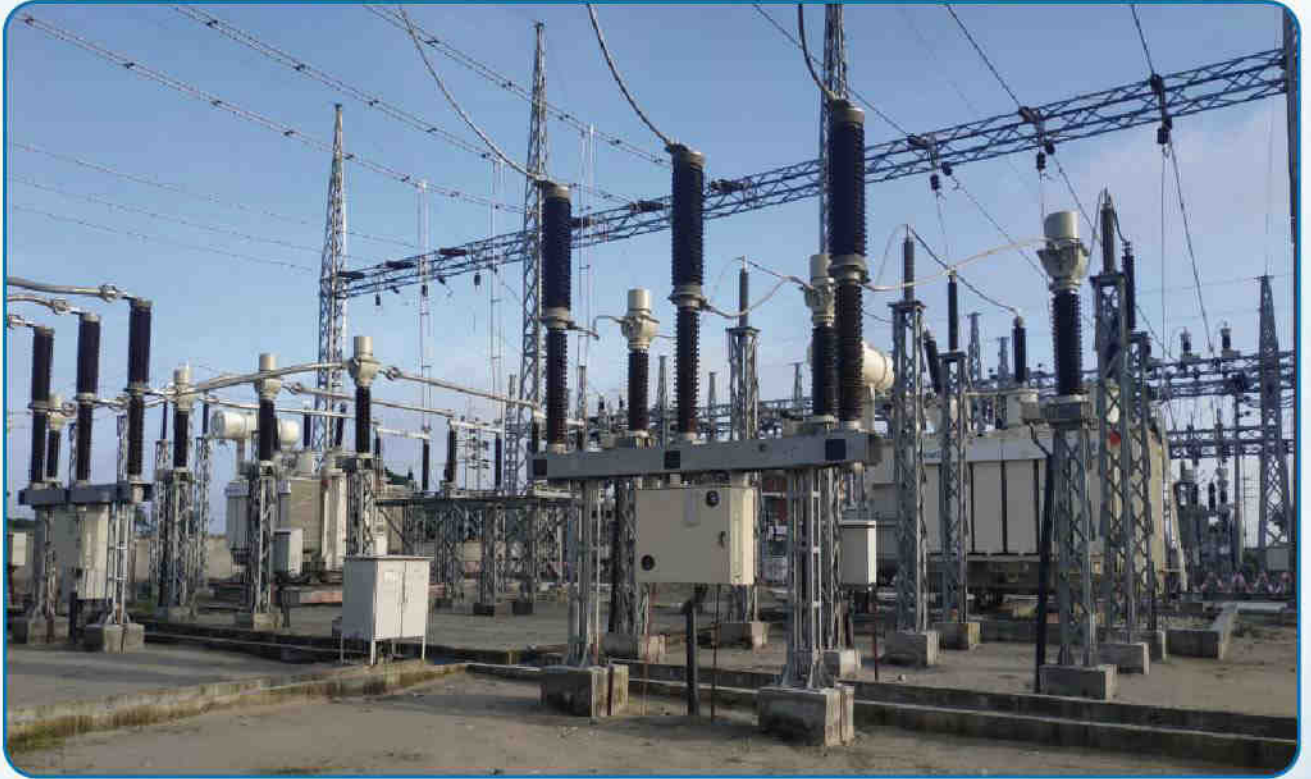
রাজবাড়ি ১৩২ কেভি সাবস্টেশন
