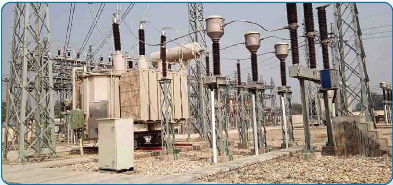
ভাঙ্গুরা ১৩২ কেভি সাবস্টেশন
