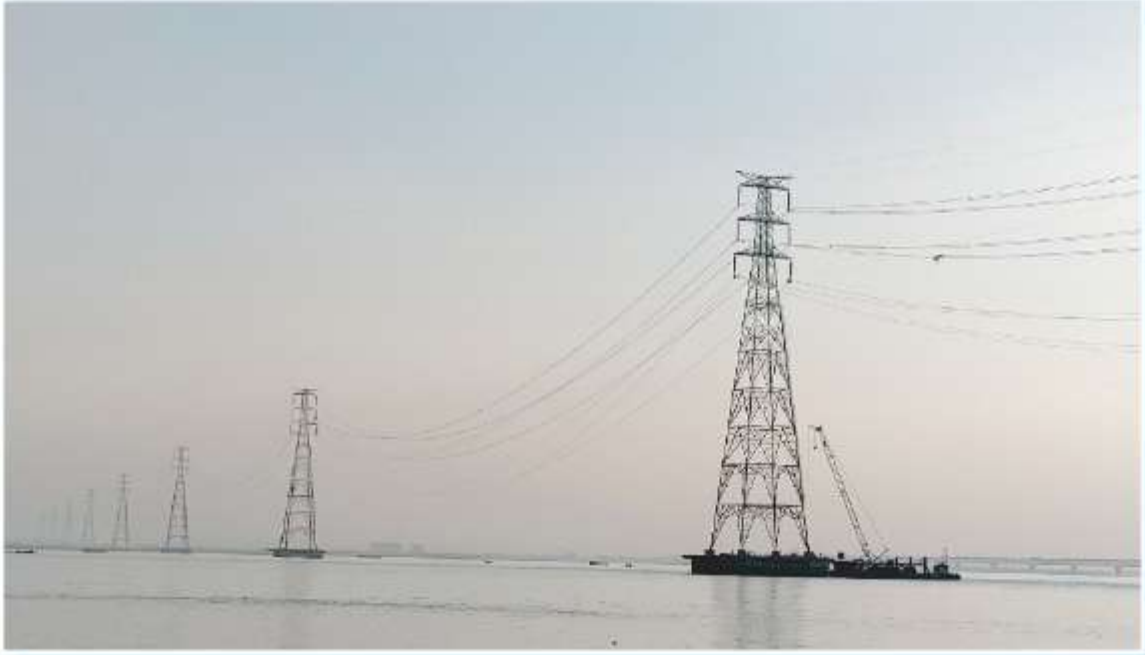
গোপালগঞ্জ-আমিনবাজার ৪০০ কেভি সঞ্চালন লাইনের পদ্মা রিভার ক্রসিং অংশ
